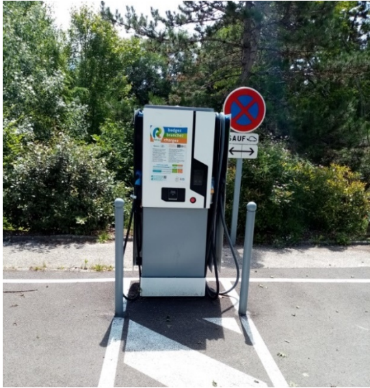
Photo 71 : Borne de recharge véhicule électrique à Salviac – Source : Even Conseil
