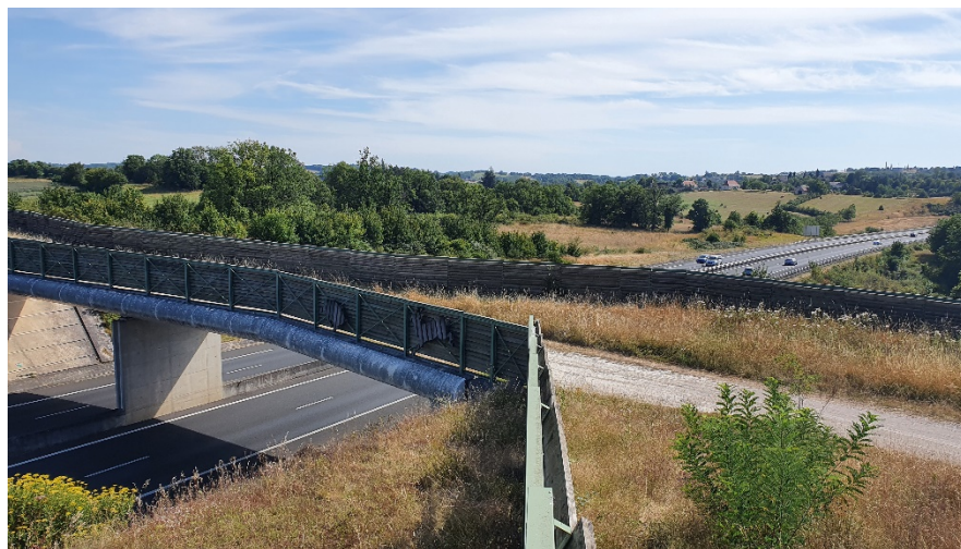
Photo 63 : Illustration des rares obstacles à la TVB présents sur le Pays Bourian : Autoroute A20. Un passage à faune supérieur est présent, permettant à la faune terrestre de franchir l'obstacle - Commune de Lamothe-Cassel - © Even Conseil, 2020
