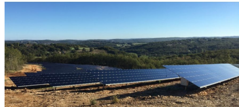
Photo 75 : Centrale solaire au sol de Salviac – Source : Photosol
